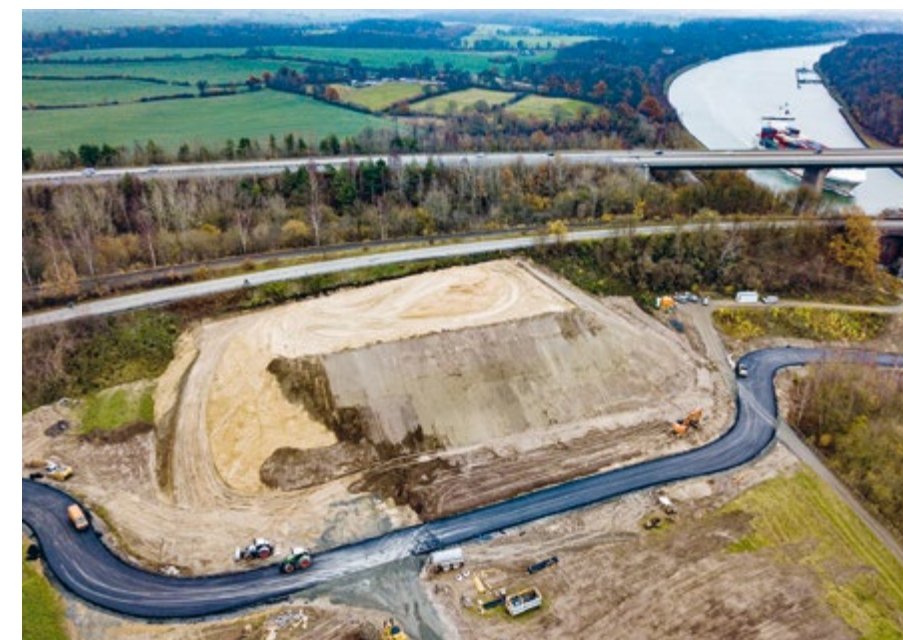
Vormontagefläche am Nord-Ostsee-Kanal: Für den Neubau der Levensauer Brücke nördlich von Kiel haben die Erdbauer eine riesige Sandhalde aufgeschüttet.
