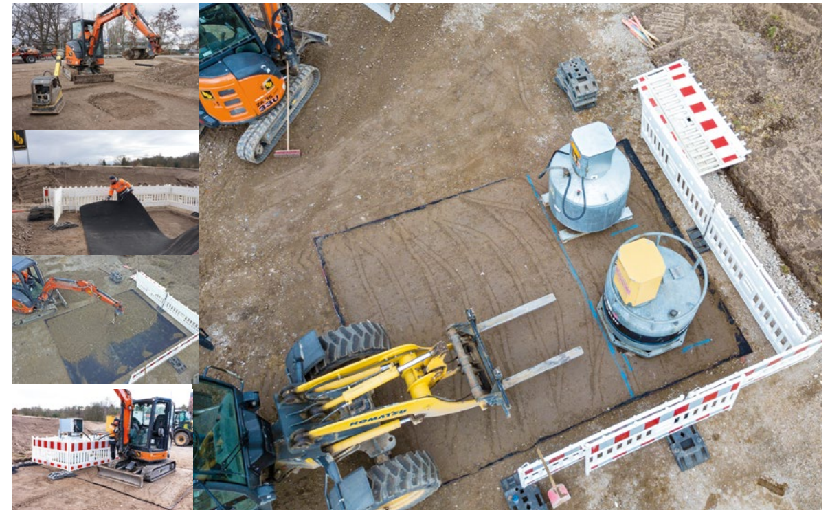
In wenigen Schritten zum havariesicheren Tankplatz: Fläche abziehen, Ölbindevlies auslegen, Material wieder andecken und verdichten, mobile Tankanlagen aufstellen, tanken, fertig.
