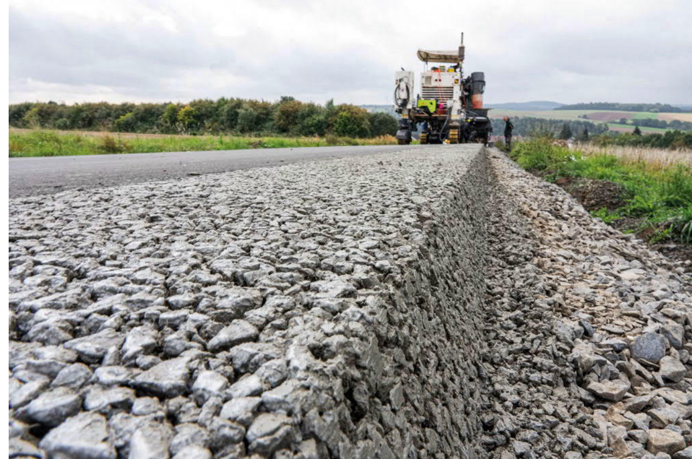
Korn an Korn und fest verbunden: Der Bankettbeton besteht aus einer Spezialrezeptur mit einem hohen Hohlraumgehalt. Für den kraftschlüssigen Verbund sorgt ein bestimmter Anteil an Polymerkunststoffen. Der Einbau erfolgte mit dem kleinen Gleitschalungsfertiger.
