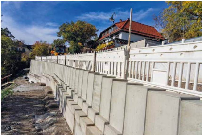
Grundhafter Straßenausbau, der es in sich hat: Die Straße An der Leite im Erfurter Stadtteil Tiefthal wird mit einer rückverankerten Stützwand gesichert.
