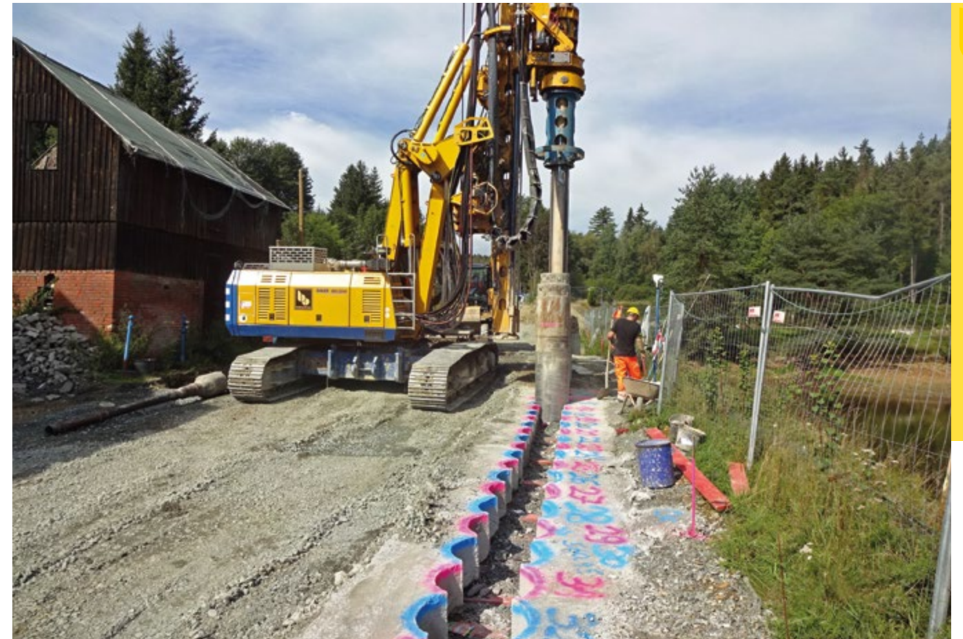
Spezialtiefbau: Mit dem Drehbohrgerät wurden die Bohrpfähle für die Stützmauer hergestellt. Bei dieser Bauweise wird nur jeder zweite Pfahl bewehrt. Dabei wurden zuerst die unbewehrten Pfähle hergestellt. Eine Bohrschablone gab die Lage vor.
