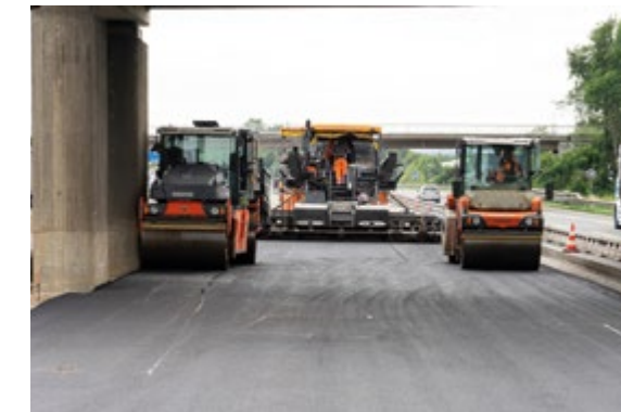
Millimeterarbeit: Das Abwalzen des Asphalts ist Präzisionssache, insbesondere im Bereich von Brückenpfeilern.
