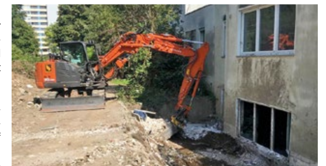
Auch im Außenbereich des Seniorenheims wurde aufgeräumt und mit einem Minibagger das feuchte Mauerwerk freigelegt.
