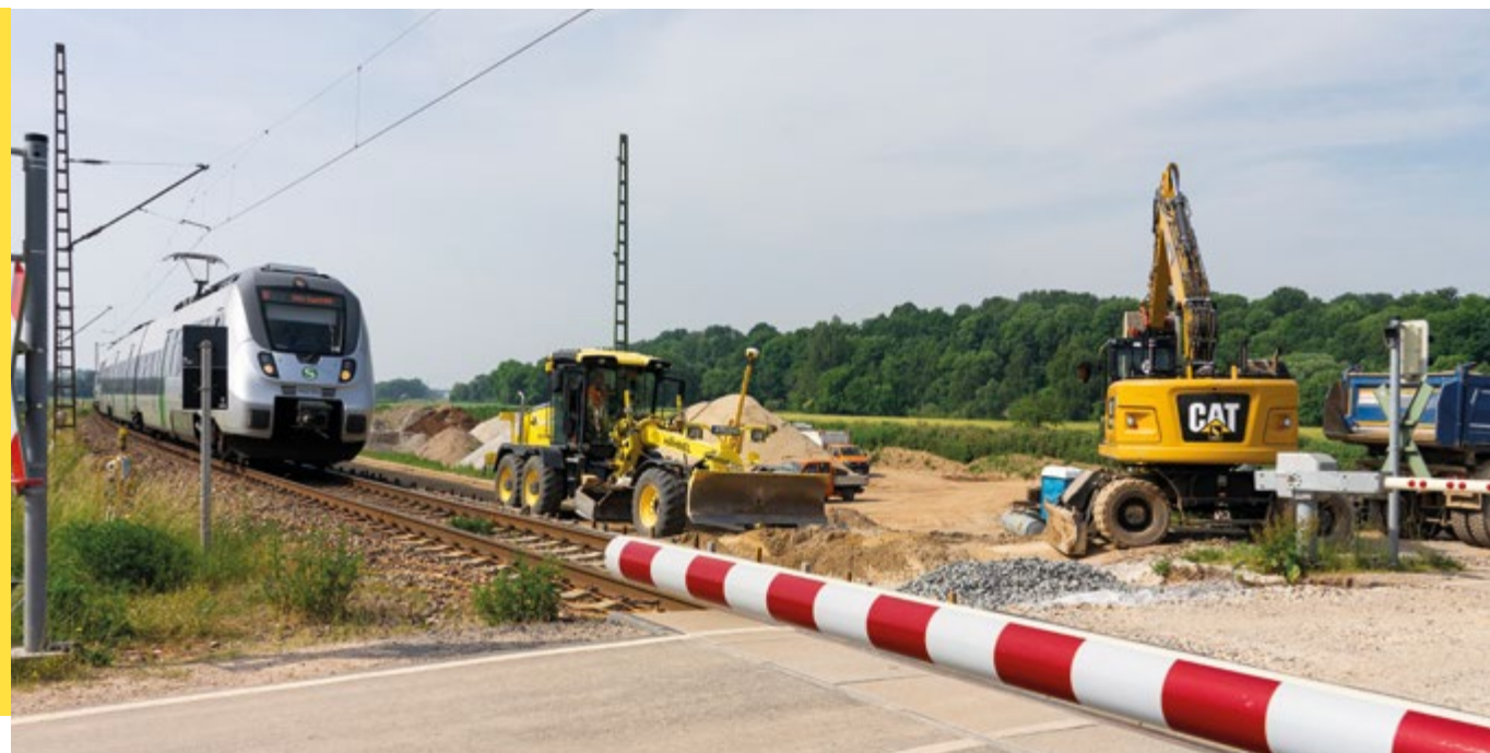
Gut getaktet: Der Ausbau der Sachsen-Franken-Magistrale bei Lehdorf erfolgt unter laufendem Bahnbetrieb. Der Bahnübergang Zehma (Foto) befindet sich etwa in der Mitte der vier Kilometer langen Ausbaustrecke.
