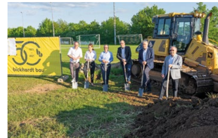
Gute Laune herrschte bei allen Beteiligten während des Spatenstichs für den neuen Kunstrasenplatz der Sportgemeinschaft Freiensteinau.
