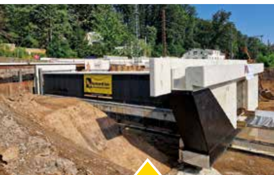
AM RICHTIGEN PLATZ: Die neue Fußgängerunterführung wurde an die richtige Stelle im Bahndamm gezogen.
