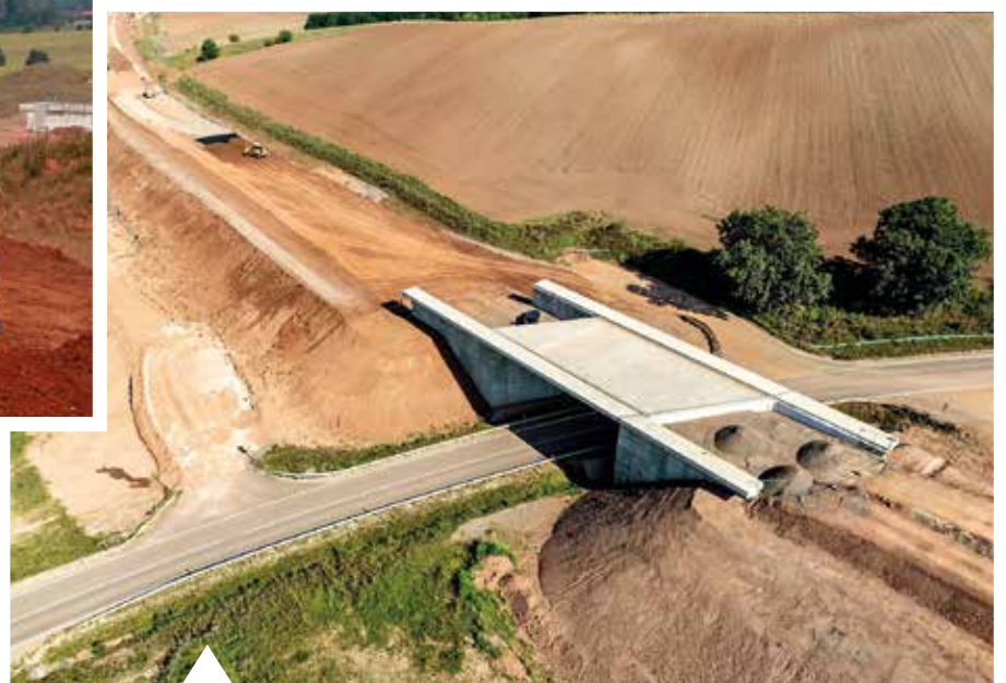
Die Abteilung Brücken- und Ingenieurbau hatte bereits vor drei Jahren zwei Brücken für die neue Umgehungsstrecke errichtet. Der Straßendamm rechts und links des Bauwerks ist nahezu auf Höhe.
